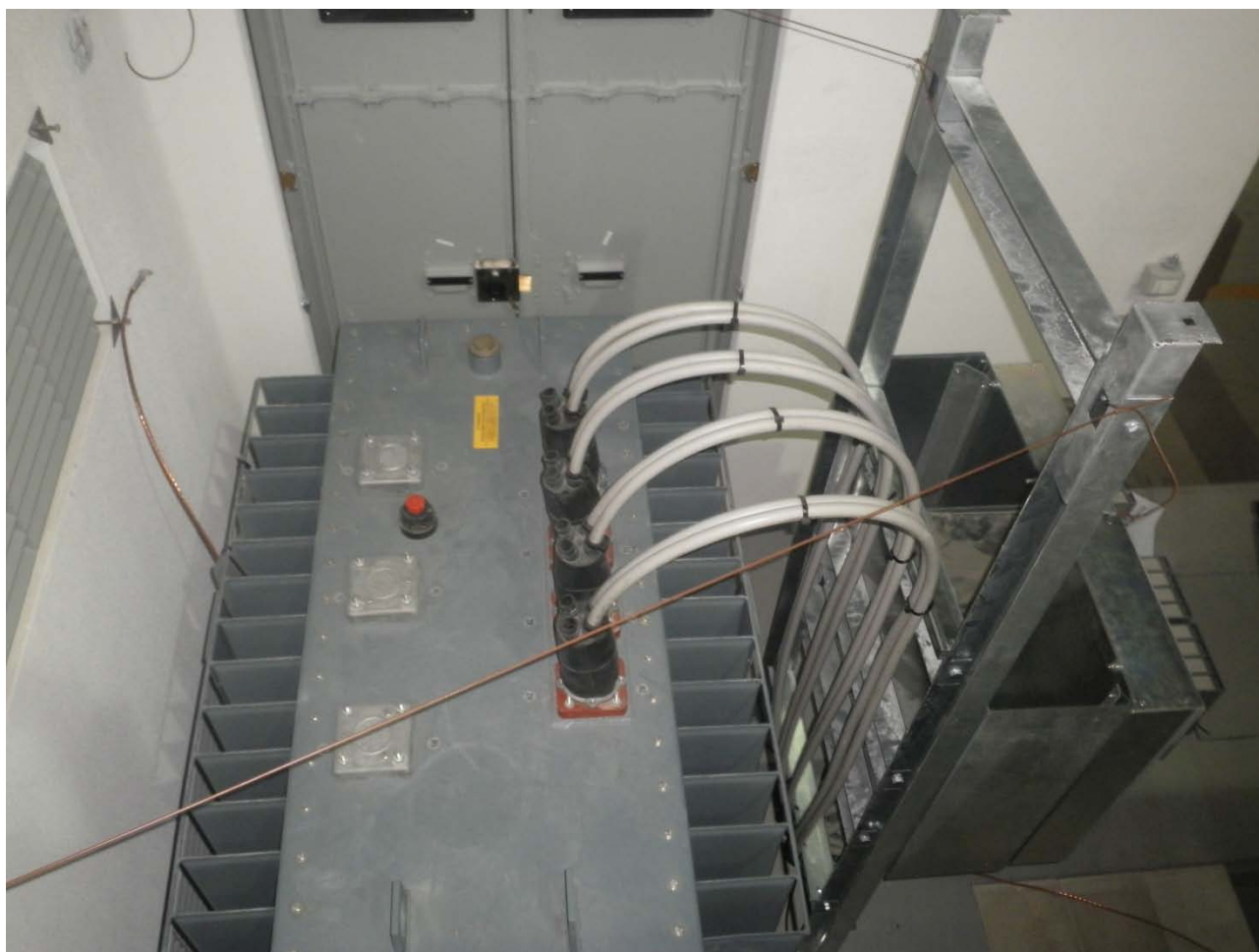
Foto 1 e 2: Esempio di montaggio Quadri BT
