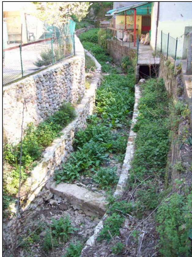
Foto 2 –Vegetazione e fogliame presente sull'alveo del Rio.
