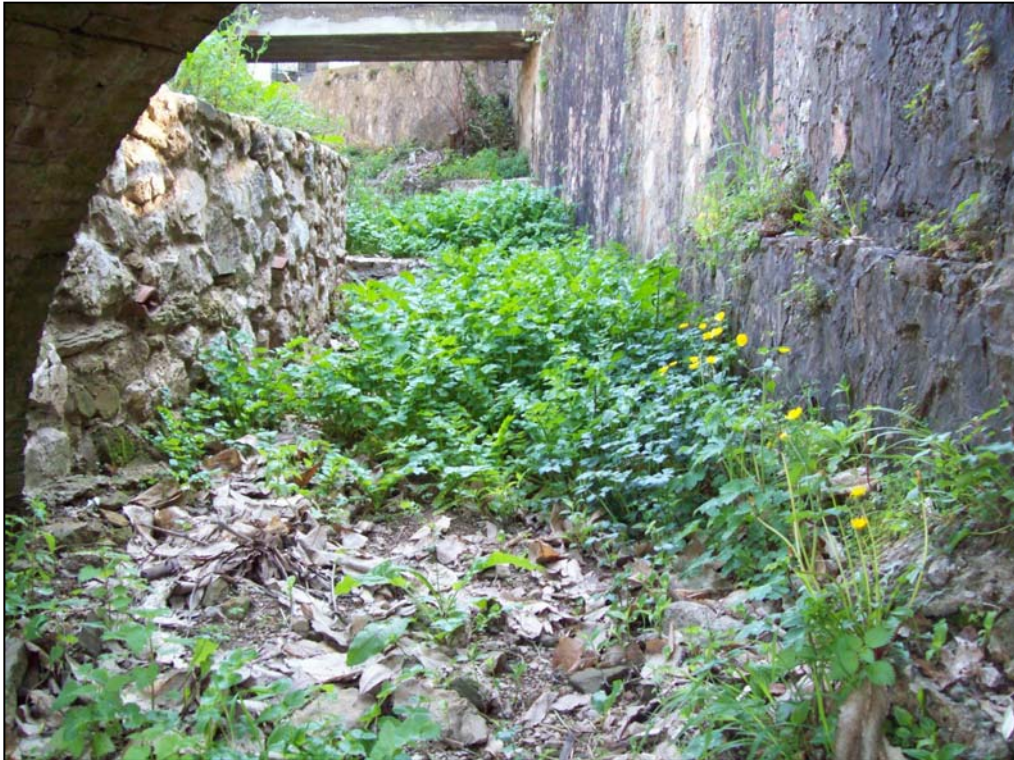
Foto 1 – Alveo e sponde cementificate; sull'alveo è presente della vegetazione
