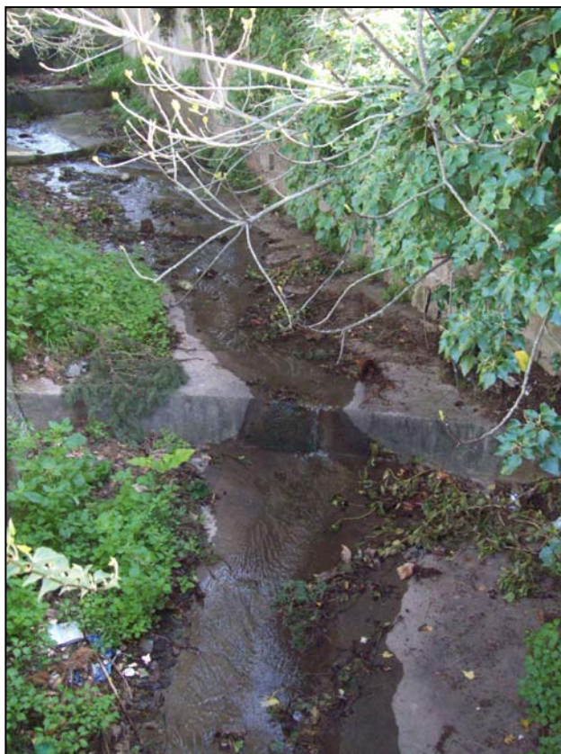
Foto 3 – Alveo e sponde del Botro della Ragnaia cementificate
